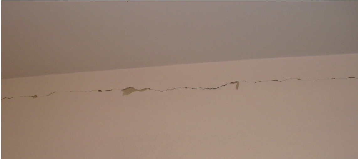
Rys. 2. Przykładowe uszkodzenia w wyniku ścinania
