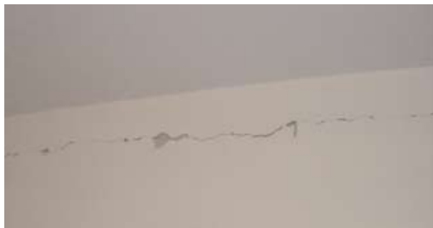
Przykład uszkodzenia na skutek ścinania
